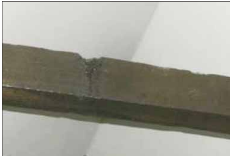
Lager und Fettspuren im Balken. Die Lagerung direkt im Holz lässt nur eine langsam drehende und schwach belastete Welle zu.
