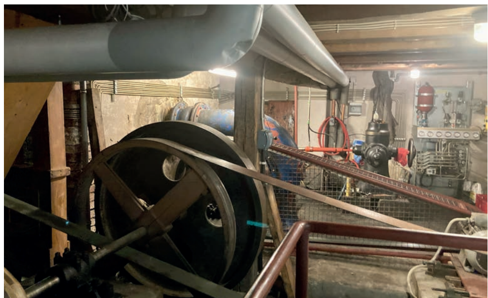
Getrieberaum der Lennemühle mit Transmissionen. Foto: Mohr 2021.
