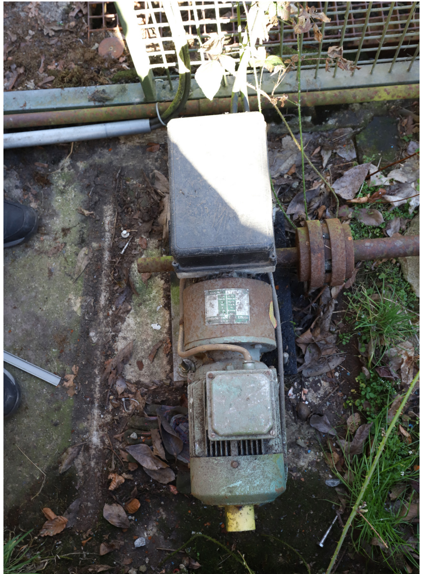
E-Motor zum Betrieb des Spannschützes
