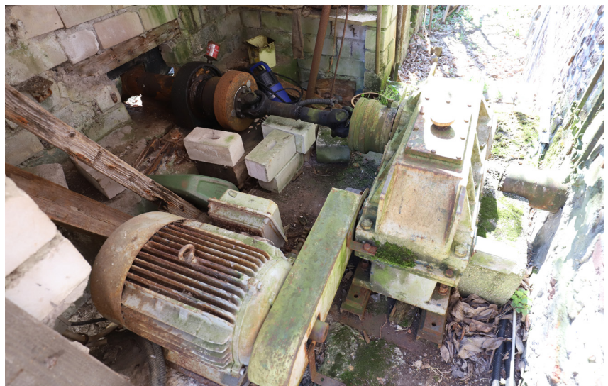
Radwelle, Lager, Getriebe und Generator
