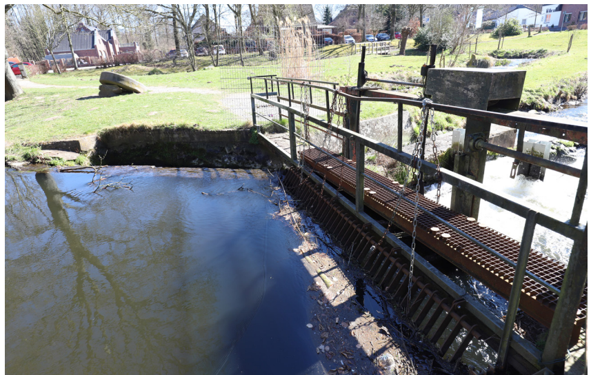
Oberwasser, Freiarche mit Bedienbrücke, Grobrechen und Überlauf zum Flutgerinne
