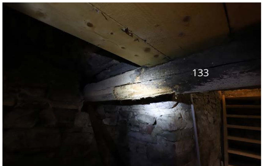
2.80 | Unteres Kellergeschoss, Arbeitsgang, Angegriffener Deckenbalken (133).
