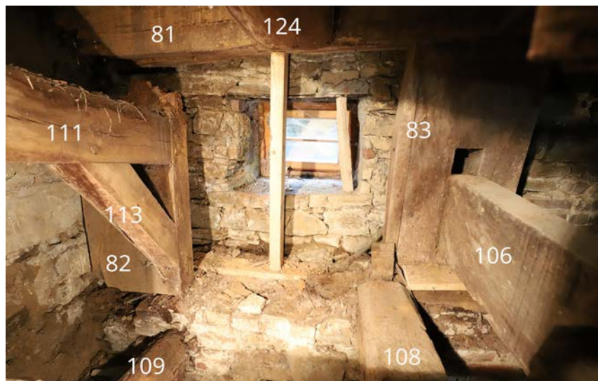
2.34 | Unteres Kellergeschoss, Mahlstuhl: abgerutschter Ständer (82) und Schwellbalken (109), da sie keine Auflage mehr haben (teilabgegangener Schwellbalken (79)).
