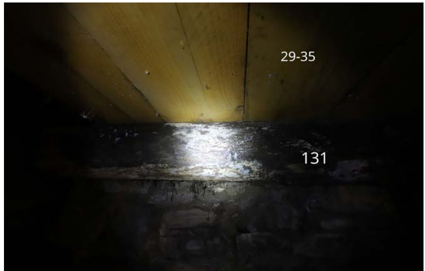
2.77 | Unteres Kellergeschoss, Arbeitsgang, Angegriffener Deckenbalken (131).
